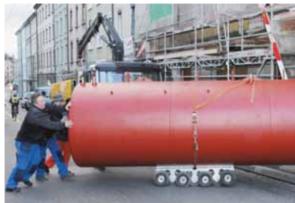
Anlieferung des Wasserspeichers, in dem Warmwasser bis in den Winter aufbewahrt werden kann.
